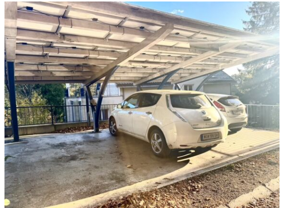
Carport mit Solarpanels
